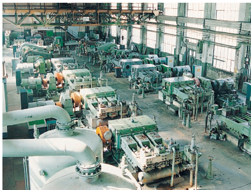
Bild 2-3: Pumpeneinheiten einer Druckwassererzeugung für eine 60 MN - Presse [S1]
