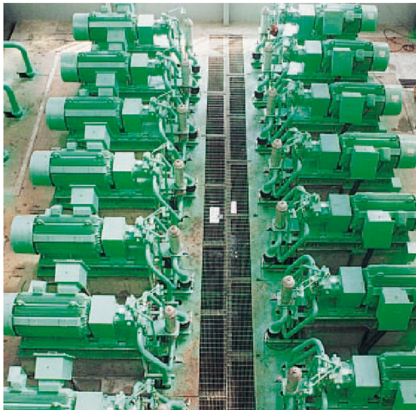
Bild 2-4: Maschinenhalle einer ölhydraulischen Hochdruckerzeugung für eine 70/100 MN - Presse [S1]
